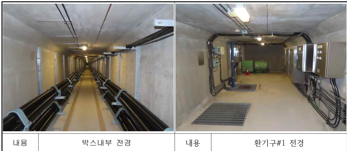
【사진 6.1】 신덕은분기 전력구 현황
